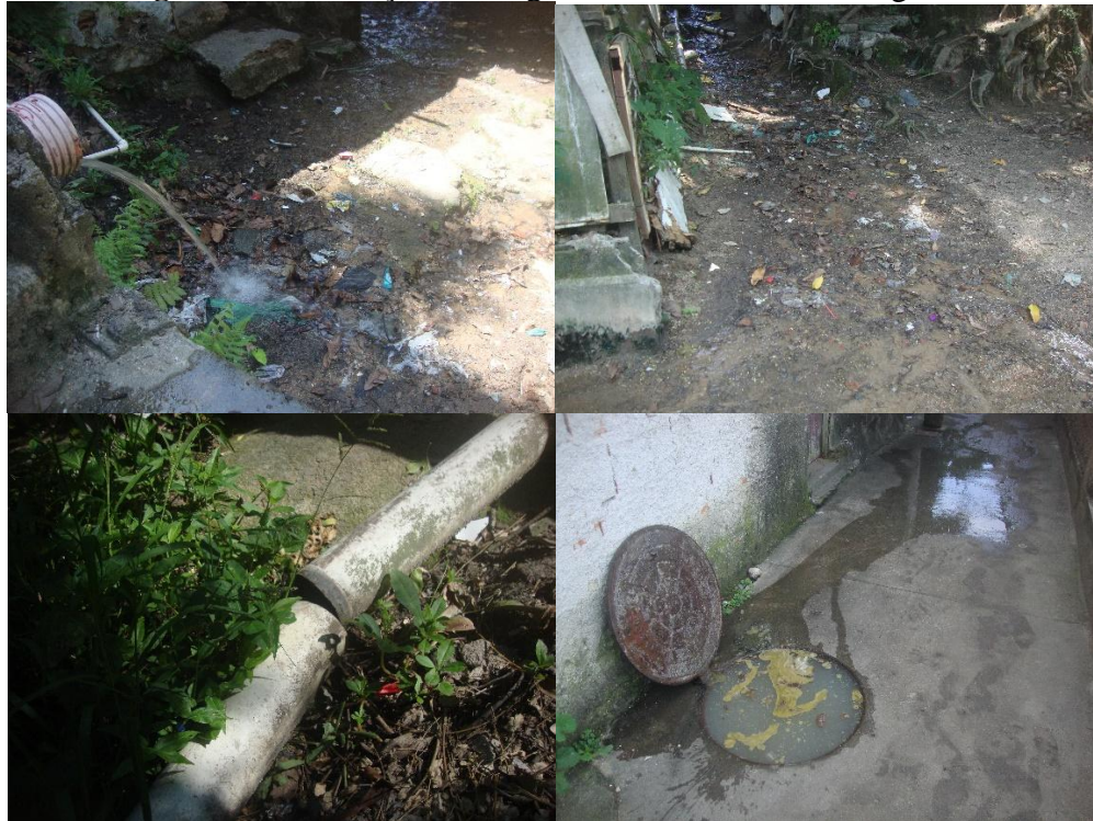
Figura 13 - Condições do esgotamento sanitário na Lagoinha
