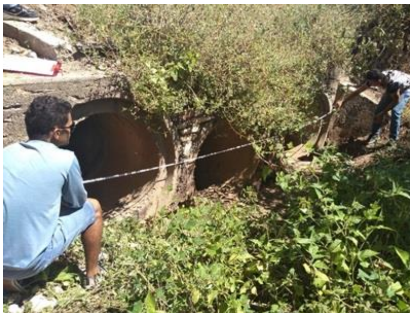
Figura 6 - Obstrução do canal por anilhamento na ST-19.
