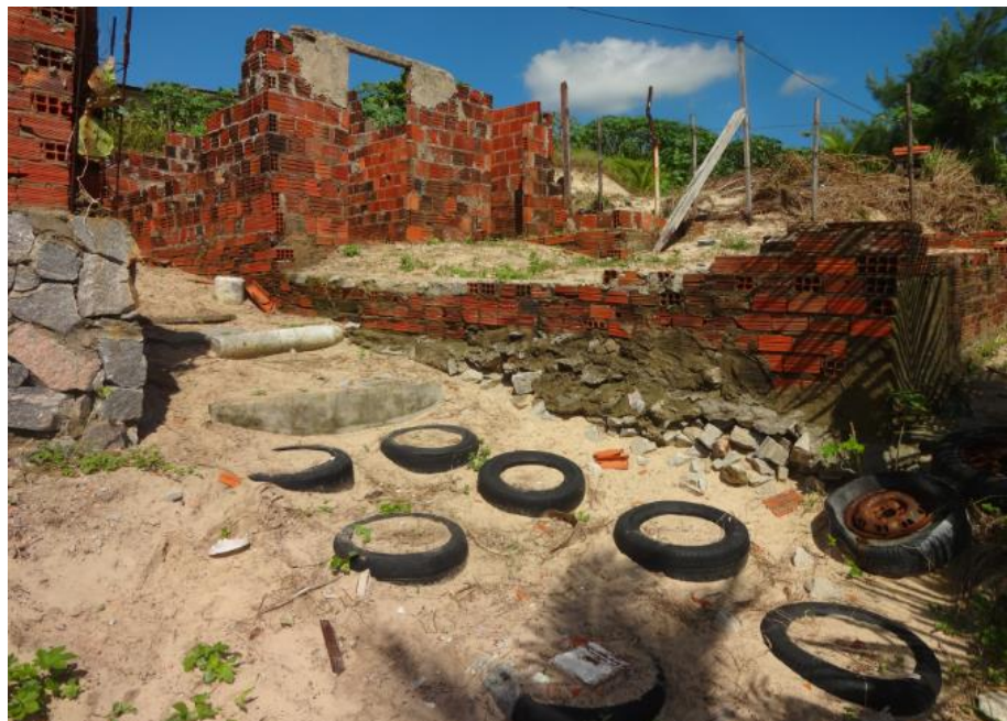
Figura 08 - Materiais utilizados no controle da erosão costeira em edificações de veraneio.
