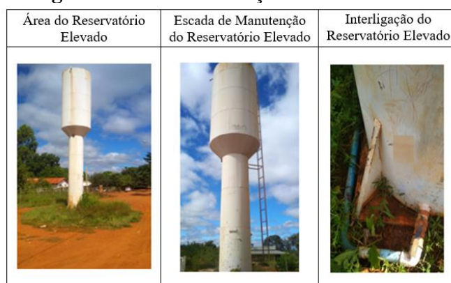
Figura 4 - Área e instalações do reservatório
