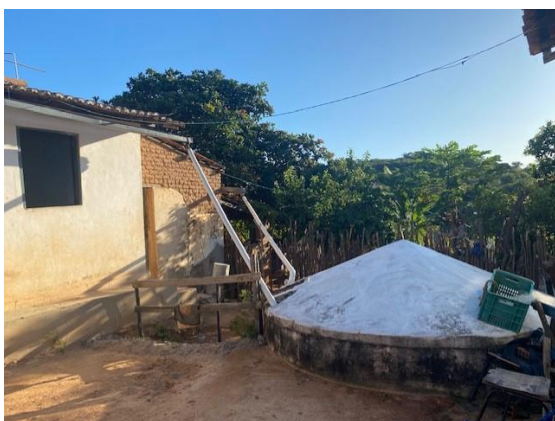
IMAGEM 2 - Cisterna residencial Comunidade Arrojado – Portalegre/RN
